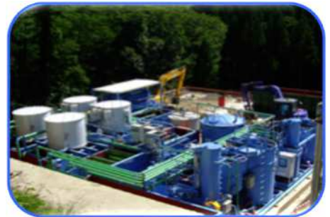
■ 濁水プラント
