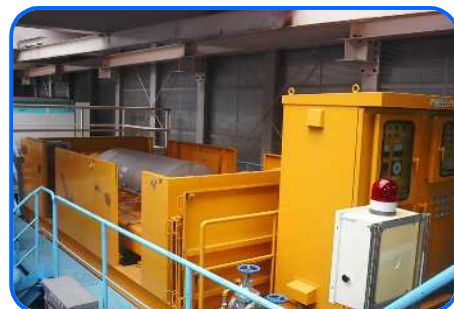
■ 泥水処理設備 (濃縮デカンター)
